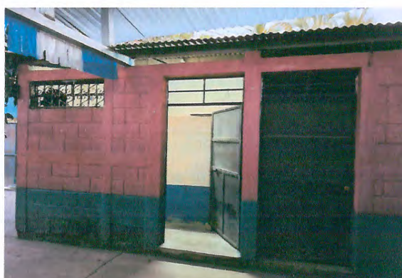
Foto 4: VENTANALES EN EL AREA DE BAÑOS
