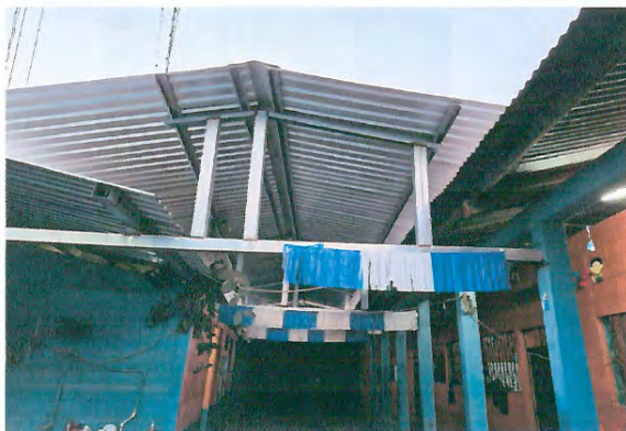
Foto 1: CAIDA DE AGUA EN GENERAL
